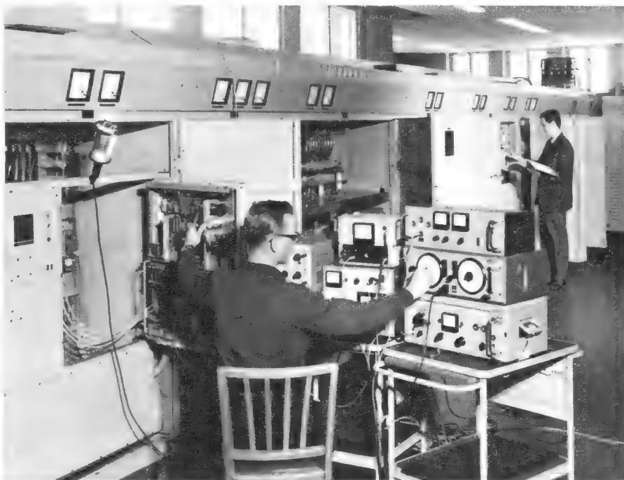
Der neue 300-kW-Mittelwellensender in Billwerder-Moorfleet bei den letzten Meß- und Prüfarbeiten
